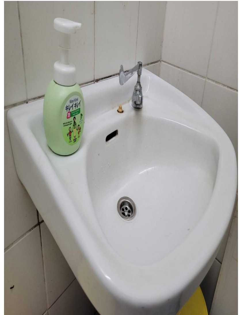
อ่างล้างมือในห้องตรวจภายใน ก๊อกน้ำเป็นแบบใบพาย
