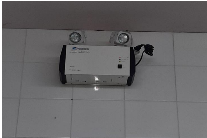
ไฟฟ้าสำรองฉุกเฉิน
